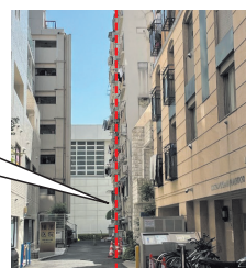
建物の傾斜の状態
