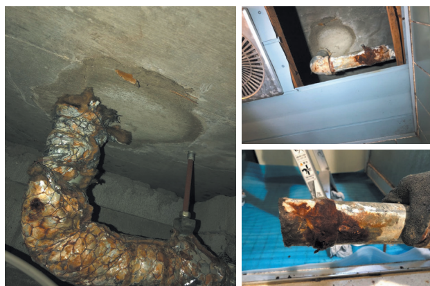
腐食した床スラブ下排水管の状況
