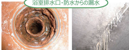
浴室排水口・防水からの漏水
