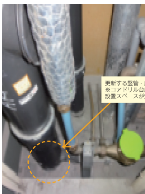
メーターボックス内配管状況
